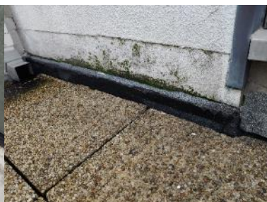
Afb.47. Aansluiting dakdetail niet afgeschermd met loden slab. Kans op waterinfiltraties + mosvorming
