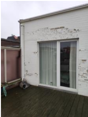
Afb.37. Afbladderende verf aan 5B
