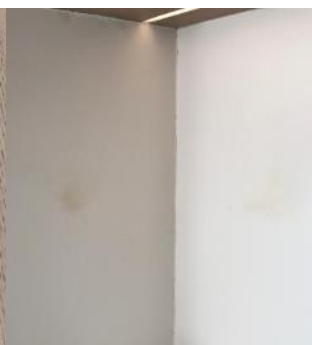
Afb.58. Gevolgschade 4A hoek muur
