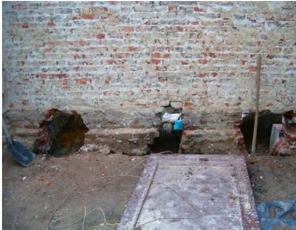
Afb.65. Referentiebeeld weggakpen metselwerk in stukken
