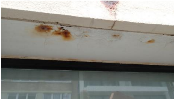
Afb.24. Beugels rond wapening zichtbaar in plaat, sterke roestvorming zichtbaar.
