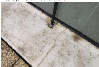
Afb.46. Voeg tussen dekstenen dak afgewerkt met een coating welke opnieuw gescheurd is
