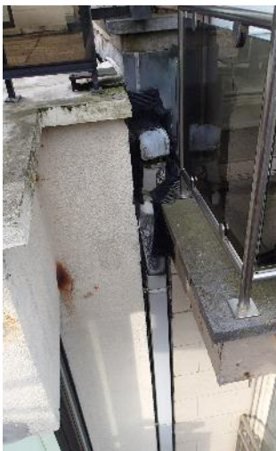
Afb.43. Gebrek aan afstand terras nr.6 tov gemene muur waardoor complexe aansluiting met regenwaterafvoer ontstaat
