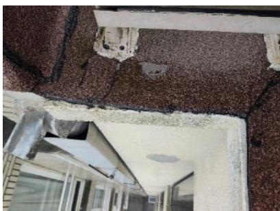
Afb.52. Ontbrekend dakrandprofiel 5A
