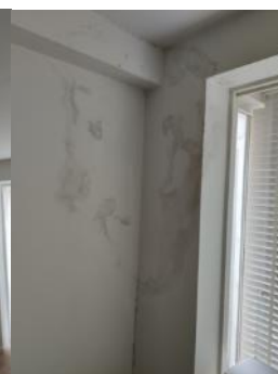
Afb.56. Gevolgschade 4E ter hoogte van raam voorgevel
