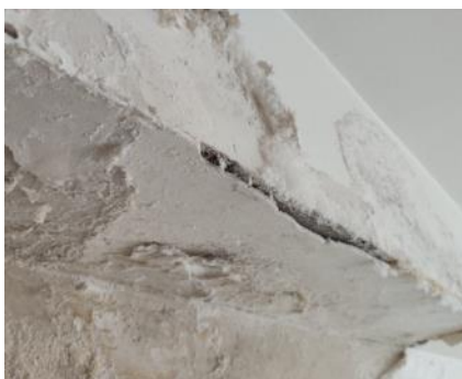
Afb.54. Gevolgschade 4E detail balk
